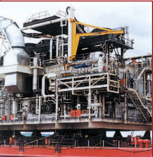
Off-Shore-Anlage für Ölplattform, Norwegen
